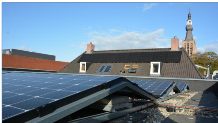
Figuur 10: zonnepanelen op het gemeentehuis
